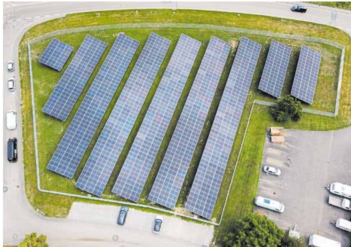
Eine Freiflächen-Photovoltaikanlage mit 2-318 Quadratmetern versorgt den Produktionsstandort der Metzgerei Gustav Winterhalter in Elzach mit erneuerbarem Strom.
